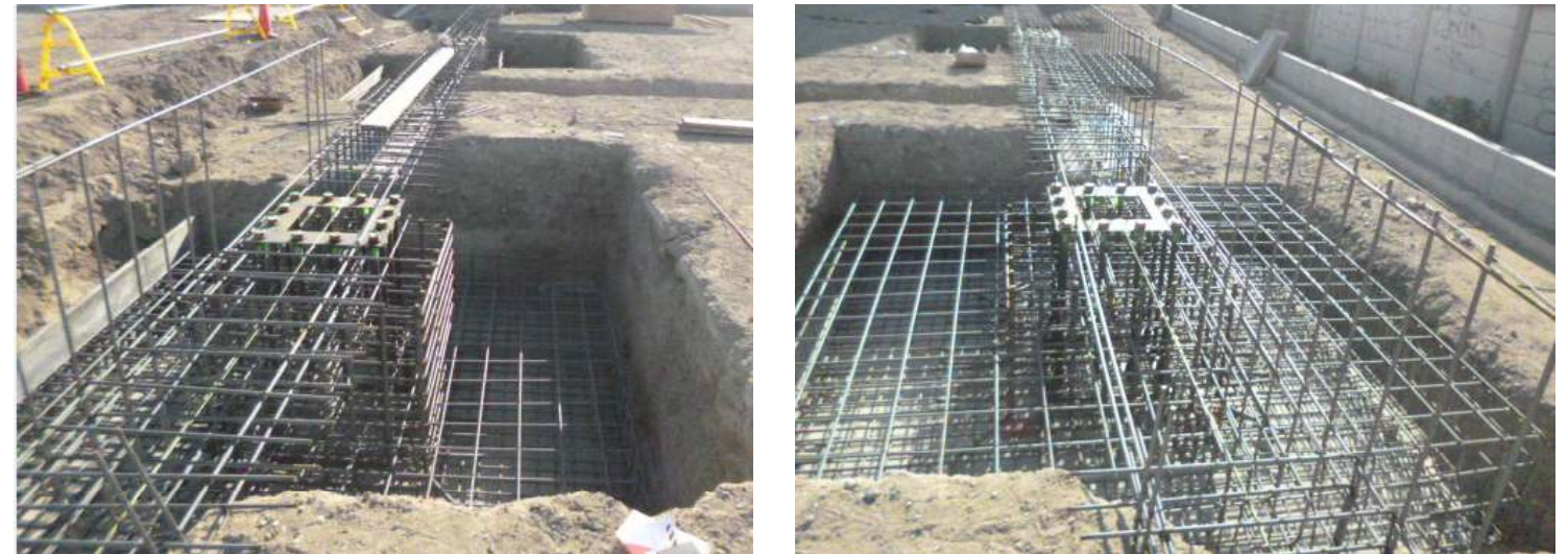
施工写真 (配筋後の状況; 型枠なしで改良面を土型枠として使用している点にご注目ください。)
